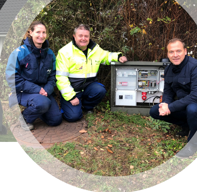
Elektriker Flemming Bentzen og Christina Olsen sammen med Niels Mølgaard foran én af de ombyggede pumpestationer.
